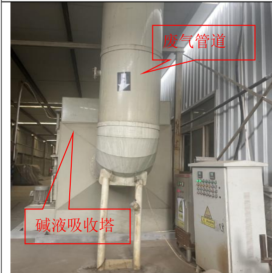
废气管道及处理设施
