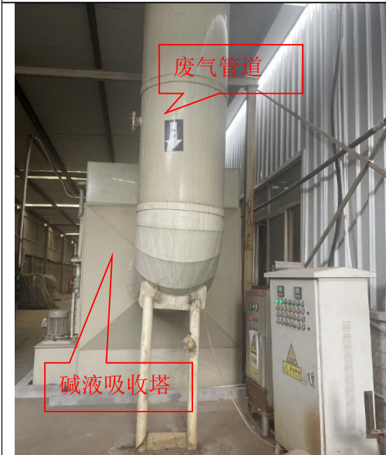
废气管道及处理设施
