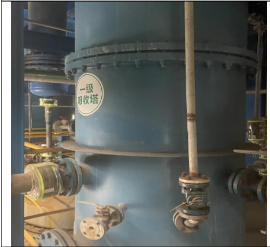
酸雾一级吸收塔
