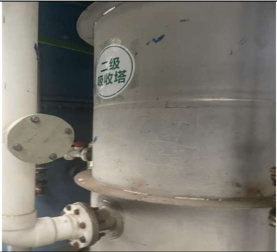
酸雾二级吸收塔
