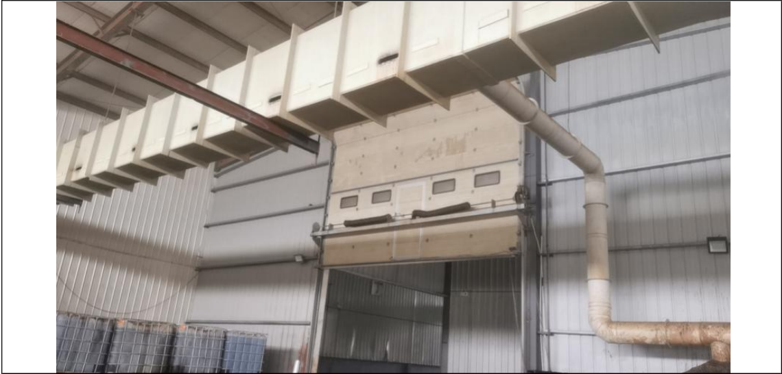
废气收集装置
